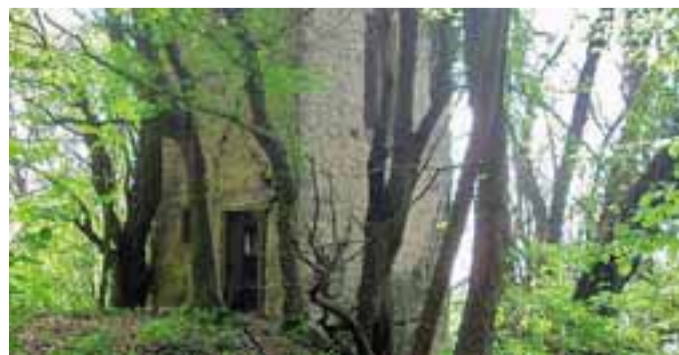
Alcuni roccoli sono fatiscenti e dovranno essere ristrutturati
